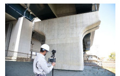
AIひび割れ解析ソリューション
