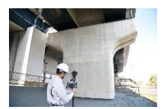
AIひび割れ解析ソリューション
