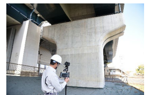
AIひび割れ解析ソリューション
